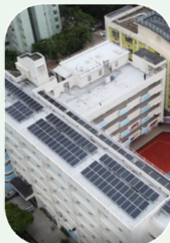
196塊太陽能 發電系統
